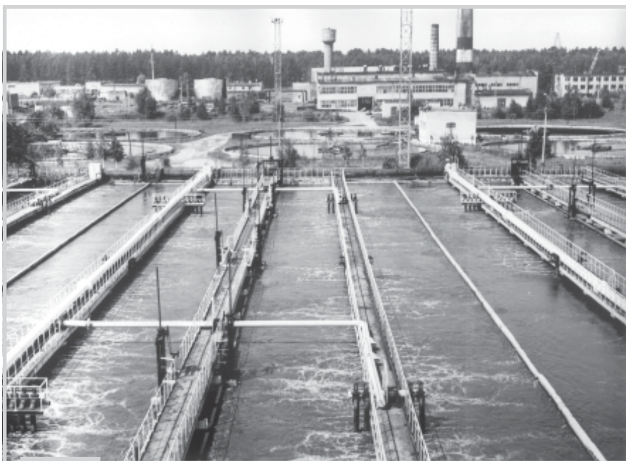
Станция очистки сточных вод (аэротенки)
